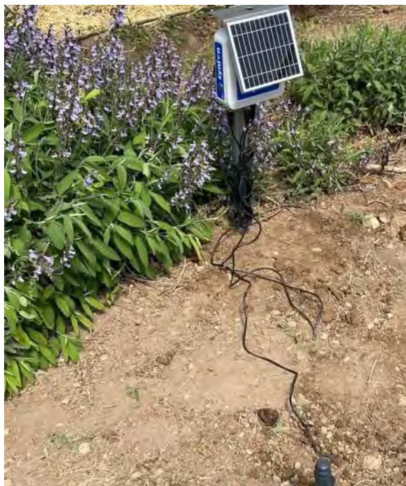
Figura 3. Sonda de humedad instalada en el CDA La Noria
