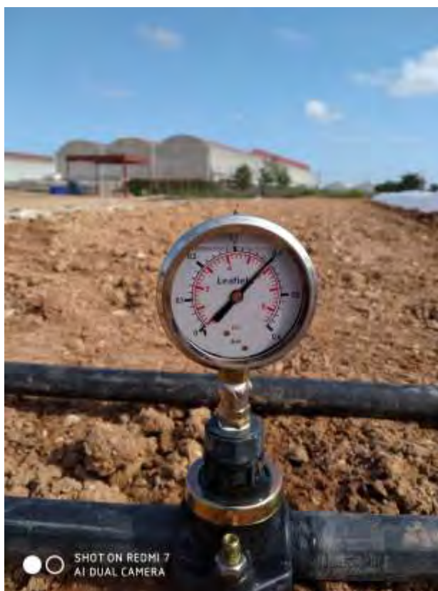
Imagen nº5 Manómetro en la zona de riego Visareg
