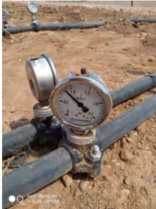
Imagen nº6 Manómetro en la zona de riego cinta
