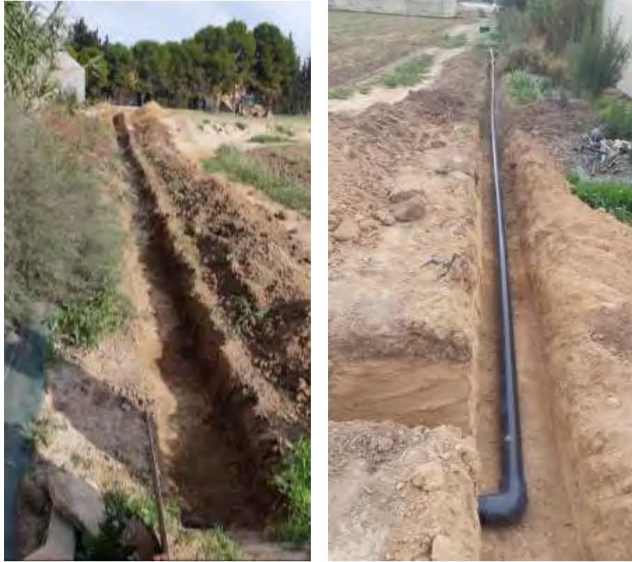
Foto nº 8. Tubería de PVC para (10/11/2021).
