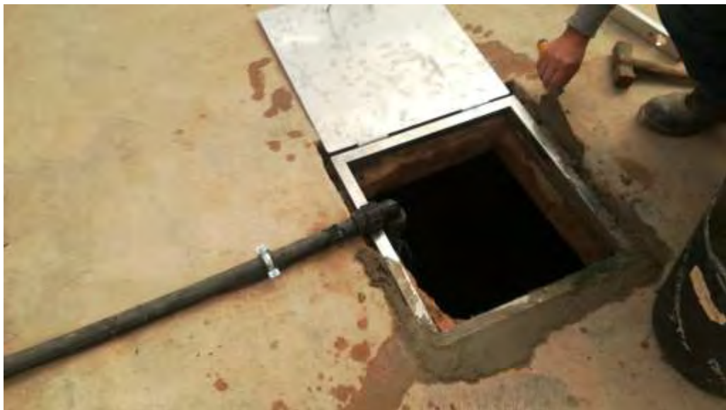
Foto nº 6. Arquetas de recogidas de drenajes.
