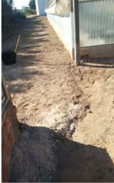
Foto nº 5. Zona por donde discurre la tubería de impulsión de drenajes, de la parte posterior del invernadero 1 a la parte delantera del 2.
