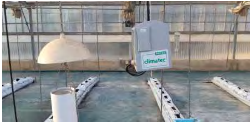
Foto nº 11. Psicrómetro para el control de automatismos por humedad atmosférica (29/11/2021).
