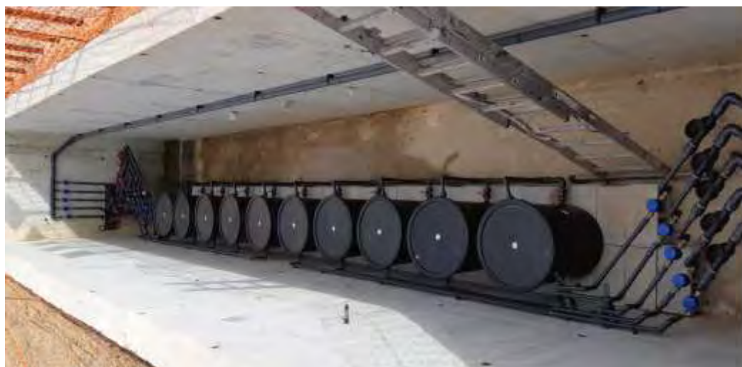
Detalle de los depósitos y del foso de recogida de drenajes.
