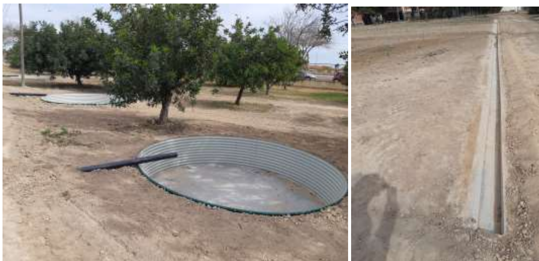
Foto 4. Aspecto de los depósitos aforadores y del canal de recogida de escorrentías (23/02/2022).
